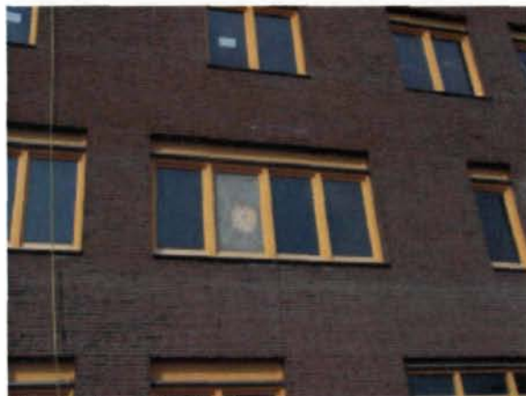
Glasschade aan de nieuwbouw
