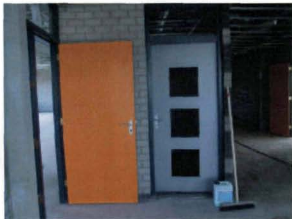
ramen in de toiletdeuren
