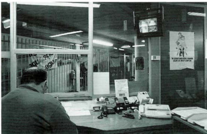
Figuur 102. De bewaakruimte van fietsenstalling Amsterdam RAI is uitgerust met een geavanceerd beveiligingssysteem.
