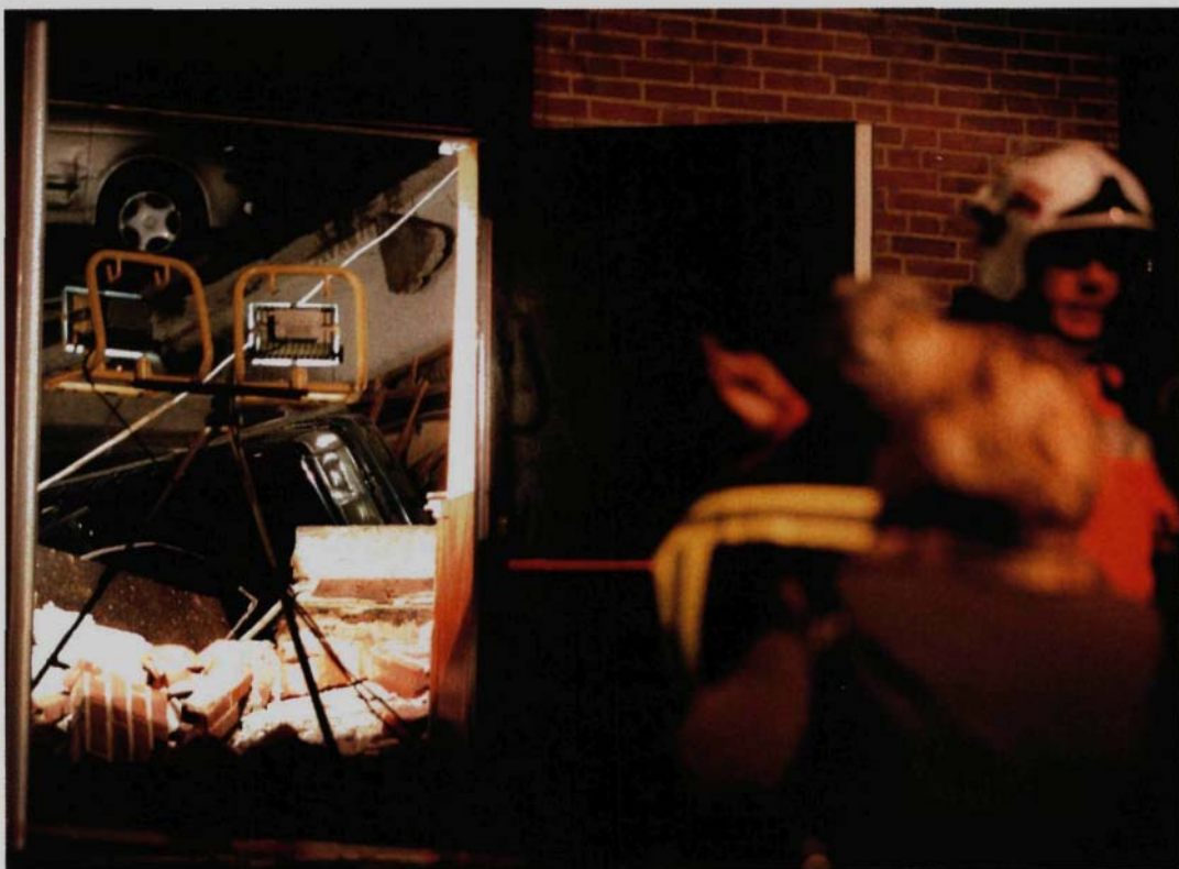
Uitzicht op het ingestorte parkeerdak van de Van der Valkvestiging in Tiel
