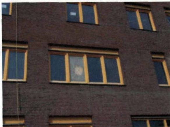
Glasschade aan de nieuwbouw
