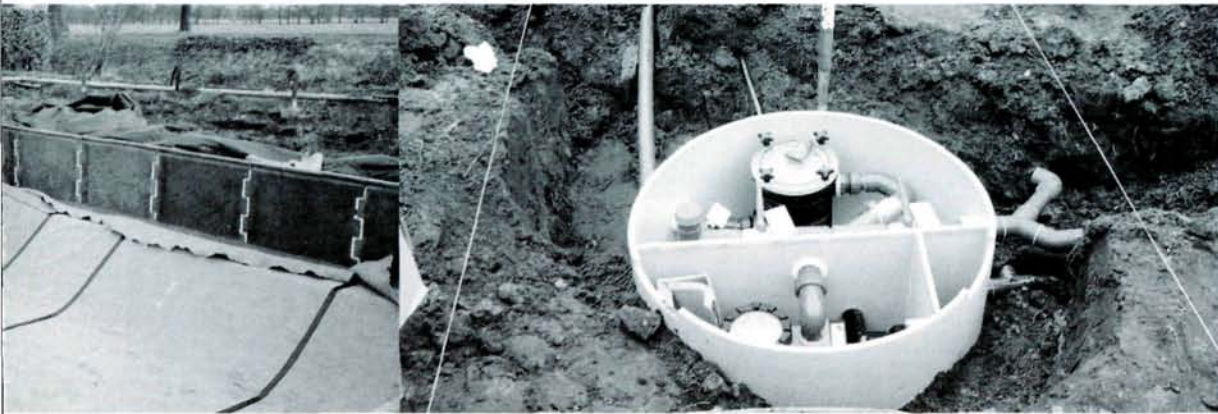
◀ De technische voorzieningen in één pompunit worden geïnstalleerd.
