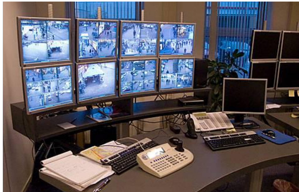
Afbeelding 2.2 Een 'uitkijktafel' in de regionale toezichtcentrale in Utrecht
