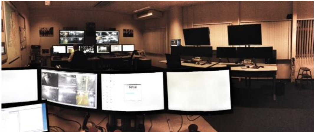
Toezichtcentrale van de RTR in Nijmegen
