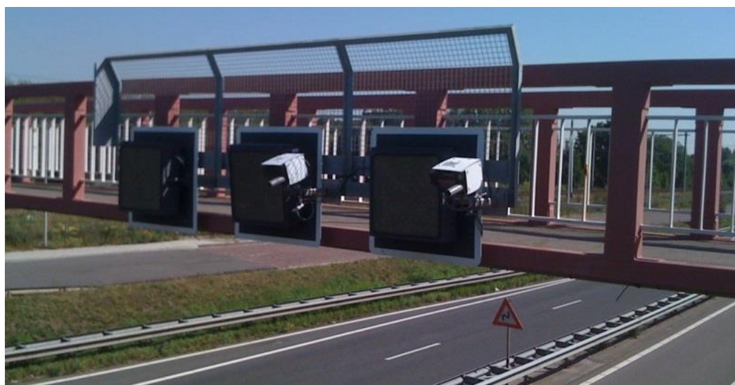
Verkeerscamera's boven een snelweg
