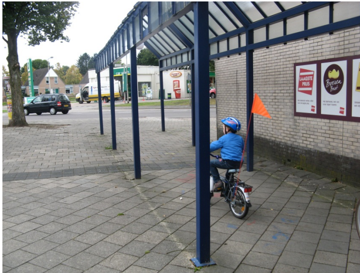
Verloedering onder luifel in huidige situatie (foto: DSP-groep)
