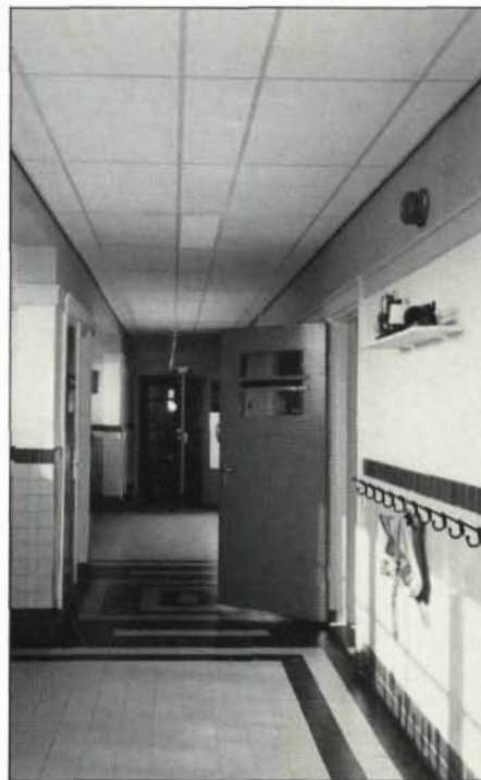
Nieuw akoestische systeemplafonds.
