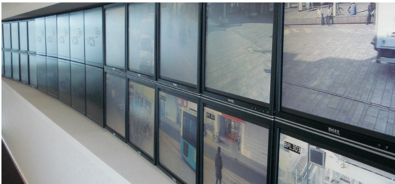
Afbeelding 2.4.7.7-6: Monitorwand in de splinternieuwe toezichtcentrale in Almere. (Foto: VCS Observation.)
